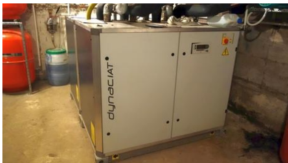
Joonis 3.1.4. Gümnaasiumi maasoojuspumbad
