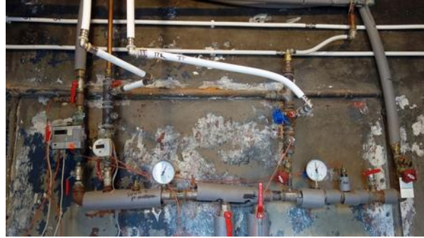
Joonis 2.2.9. Apteegi soojussõlm
