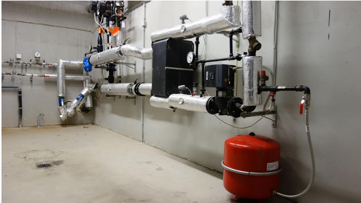
Joonis 2.4.16. Luua Metsanduskooli õppehoone soojussõlm
